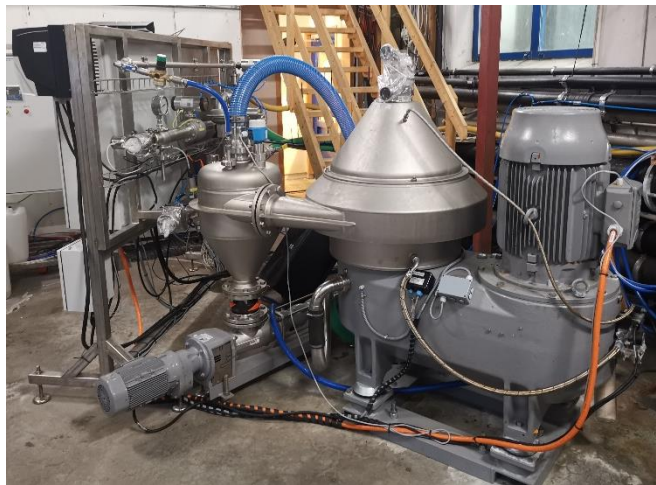
Bilde 2 Sentrifuge montert under fullskaletesting. Ventilrigg kan skimtes i venstre del av bilde. Slamoppsamler sess til venstre for selve sentrifugen, med skruerpumpe monteret i underkant av denne.
