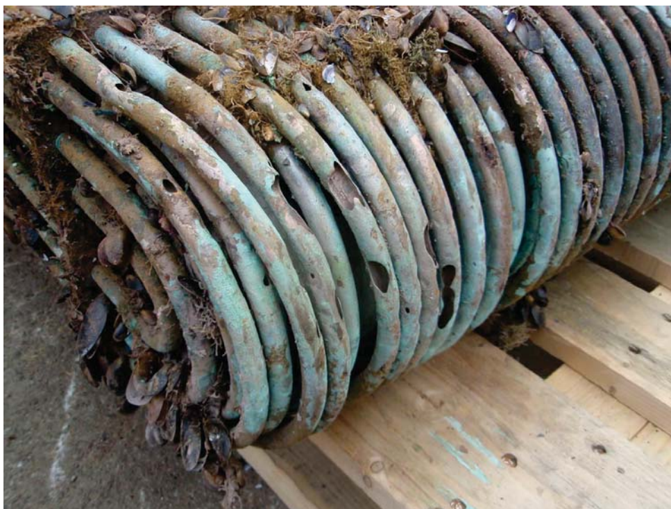
Figur 15. Skader og marin begroing på bokskjøler. Årsak til korrosjonsskadene er ikke kjent.
