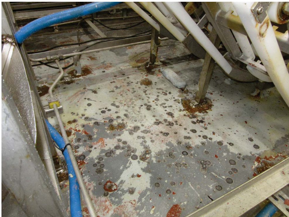
Figur 29. Umalt fabrikkdekk i karbonstål med korrosjonsangrep og anode med begrenset rekkevidde
