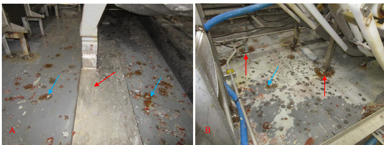
Figur 12. Korrosjonsangrep i vått område på malt karbonståldekk nær rustfrie doblingsplater (→) og i skader i belegget (→)
