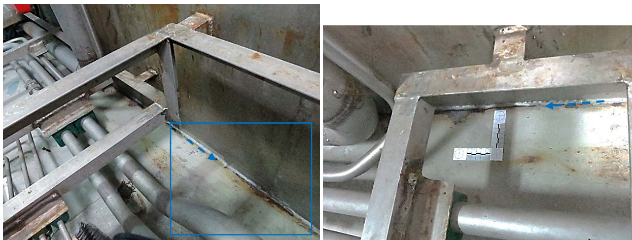
Figur 15. Korrosjonsangrep i overgang mellom karbonståldekk og rustfritt skott (→)
