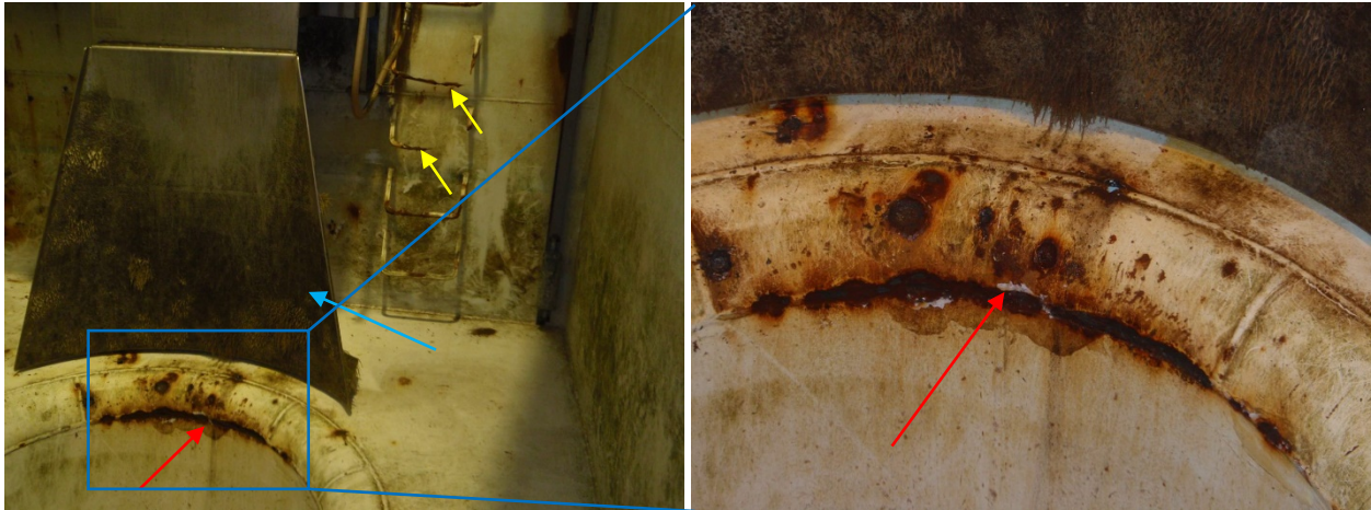
Figur 18. Korrosjon på malt karbonstål i dragerbrønn (→) med ei rustfri plate/skjold (→) . Trinn i stigen (→) i dragerbrønneren er delvis korrodert bort
