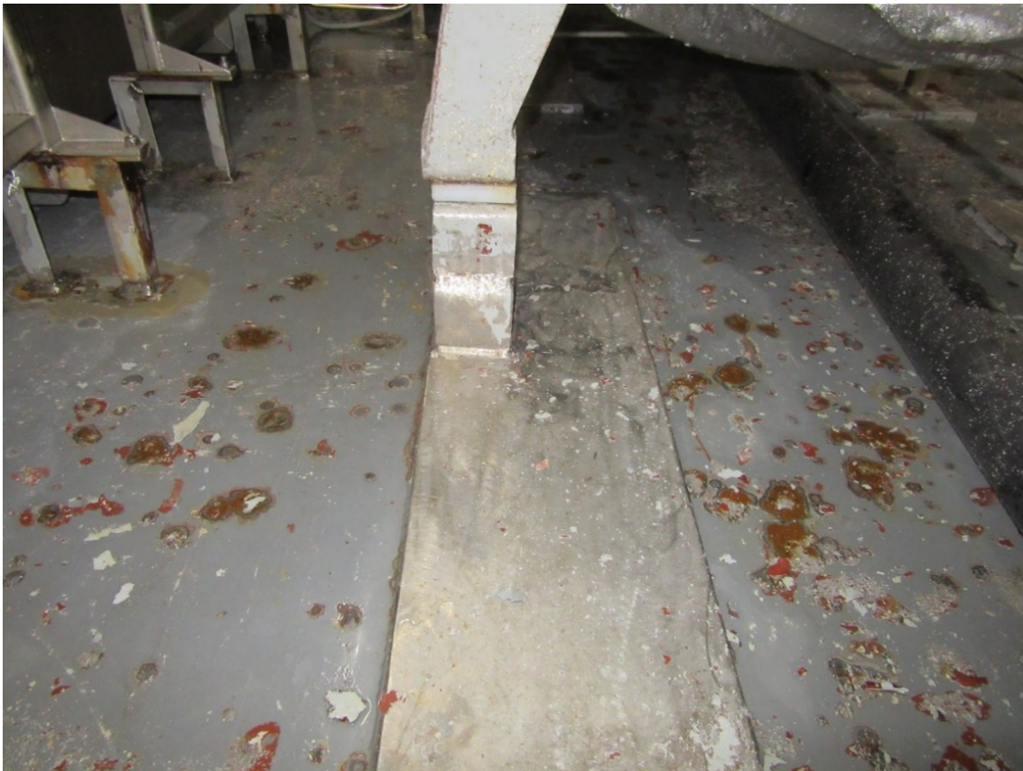
Figur 4-2 Dobblingsplate i 316/304 i vått område med korrosjonsangrep på karbonståldekk
