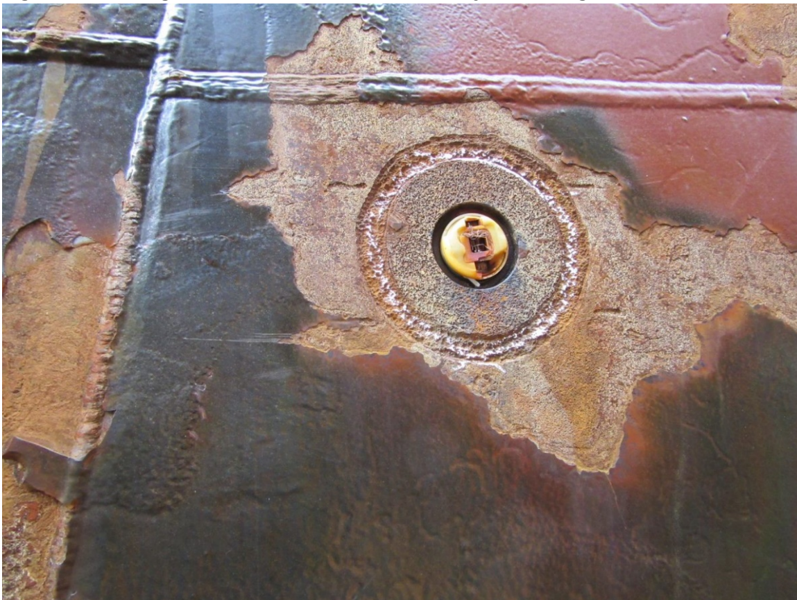
Figur 4-47 Ødelagt referanseelektrode med korrosjon omkring
