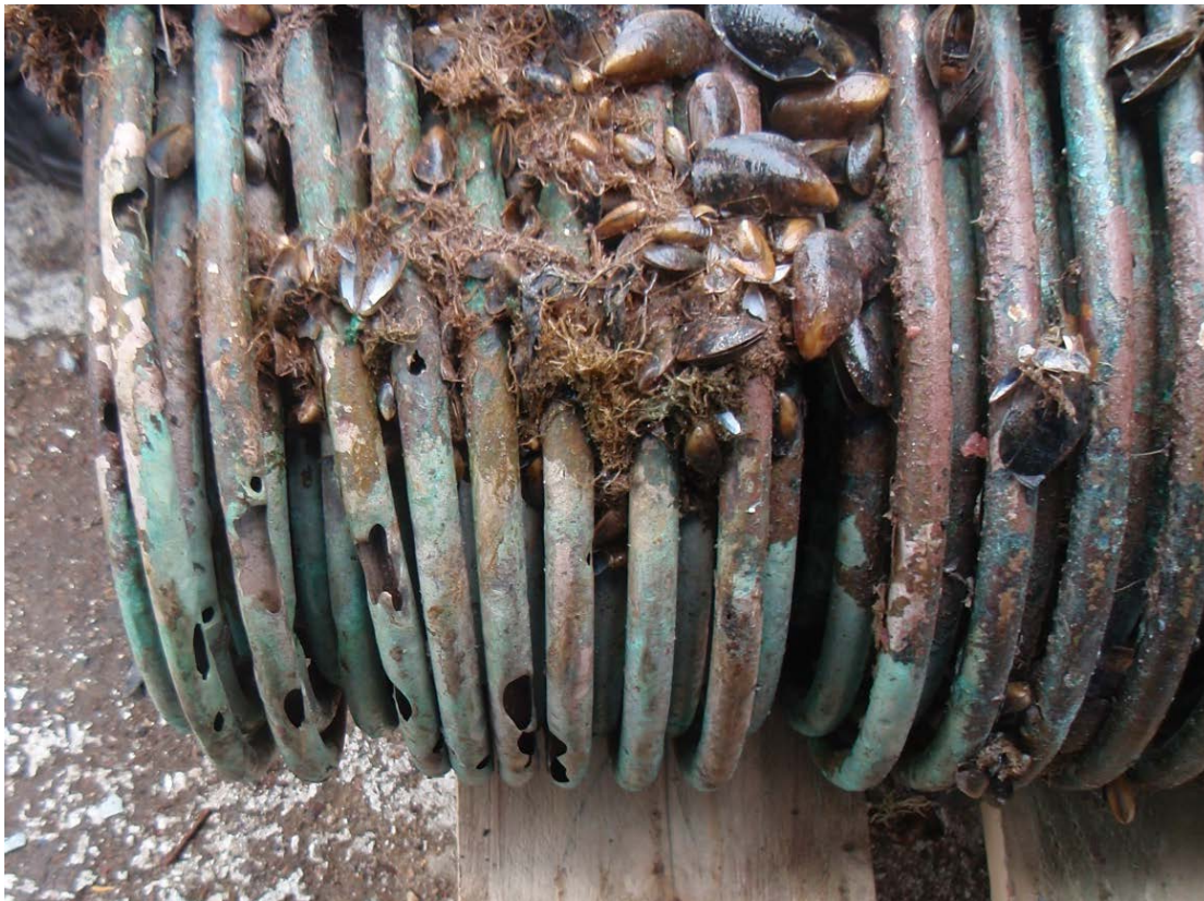
Figur 4-26 Bokskjøler i kobbernikkel med lekkasjeskader
