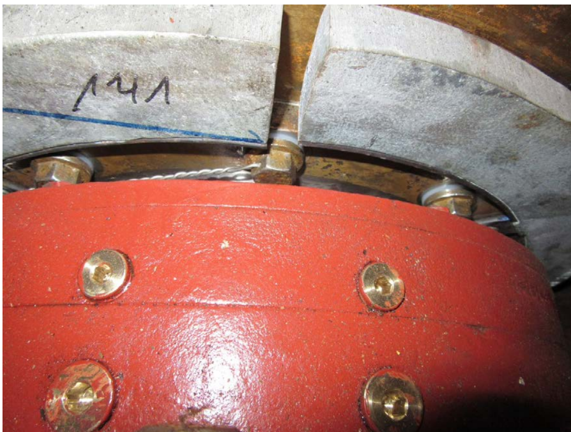
Figur 4-40 Reparert og malt hylsetetning fra Figur 4-38
