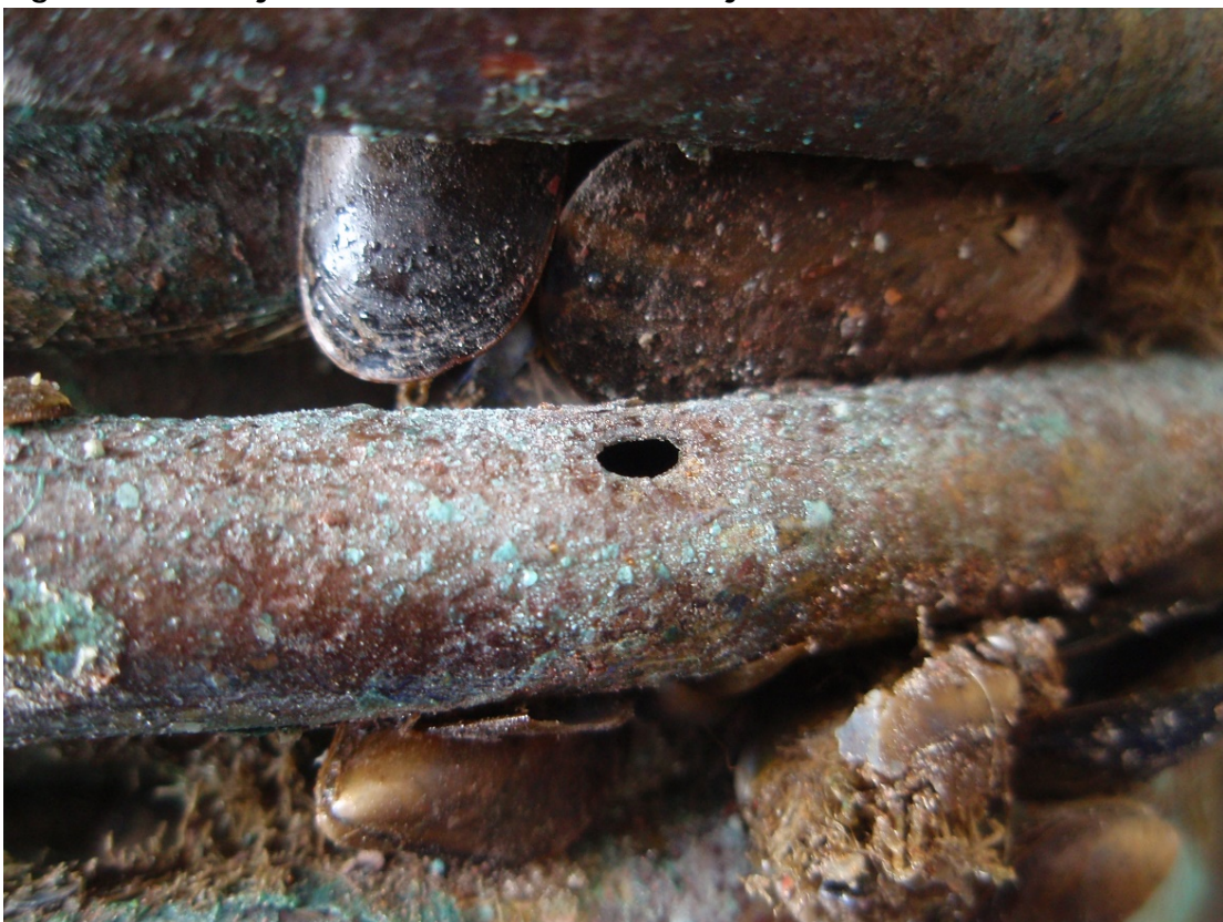
Figur 4-27 Hull i CuNi rør på bokskjøler
