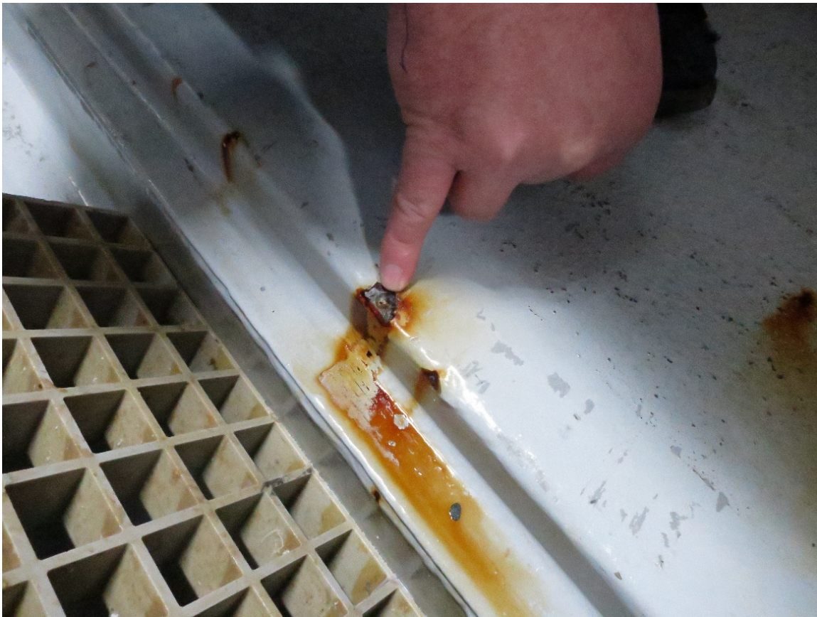
Figur 4-8 Korrosjonsangrep i sveis på karbonståldekk
