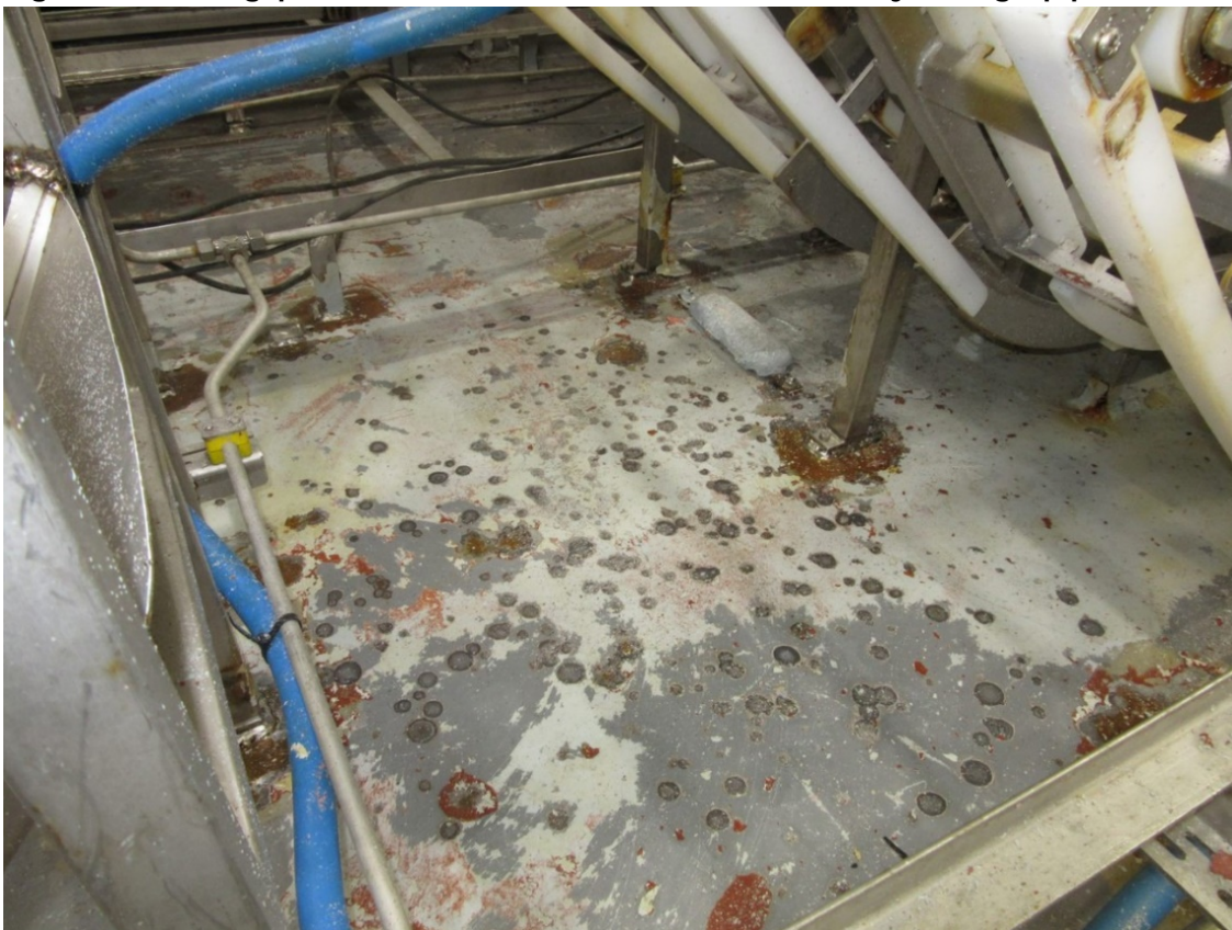
Figur 4-3 Malt karbonståldekk med korrosjonsangrep i ødelagt malingsbelegg
