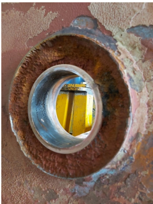
Figur 4-36 Lager/foring i bronse mot karbonstål for flap-mekanisme. Foringen forårsaker galvanisk korrosjon på stålet omkring lageret.
