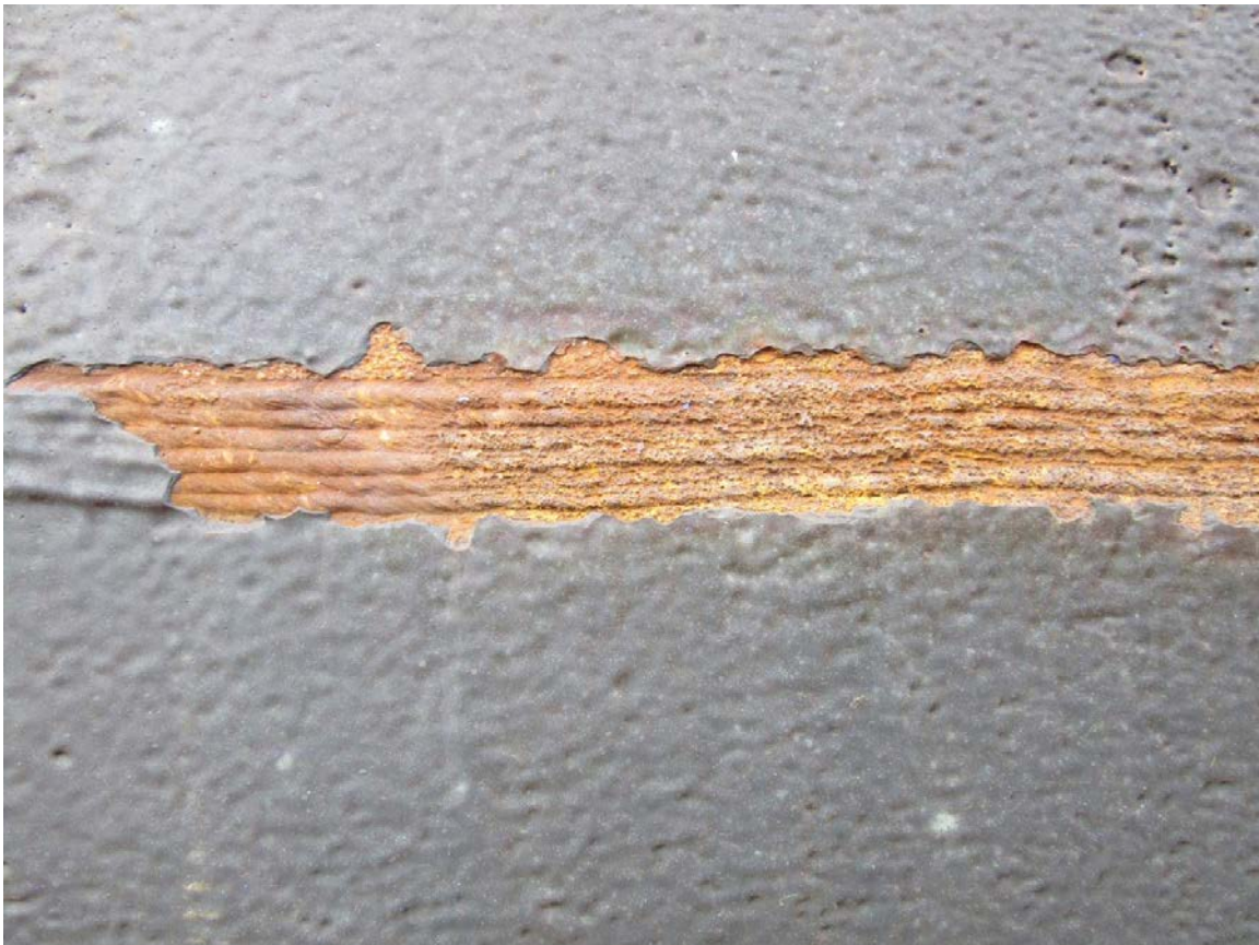
Figur 4-45 Nærbilde av sveis med korrosjon
