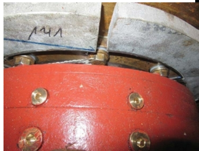
Reparert hylsetetning med sinkanoder
