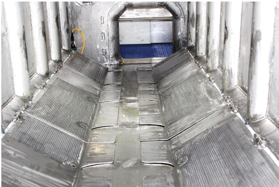
Bilde 3 Inntakstank nr. 4 med skrå bunn. Vannforsyningen i tanken kommer opp på undersiden av den perforerte bunnen ut mot sidene av tanken, med cirka 50 cm avstand. Bunnplatene er hengslet ute i sidene og kan slås opp ved behov.
