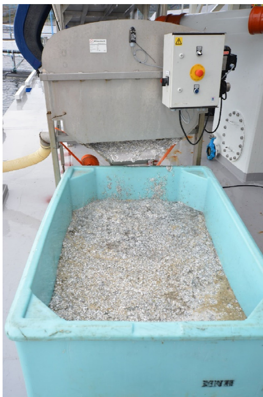
Figur 15 – Oppsamling av biologisk materiale (hovedsakelig skjell og lus) etter filtrering av avløpsvann fra Hydrolicer LG9332 Hydro.
