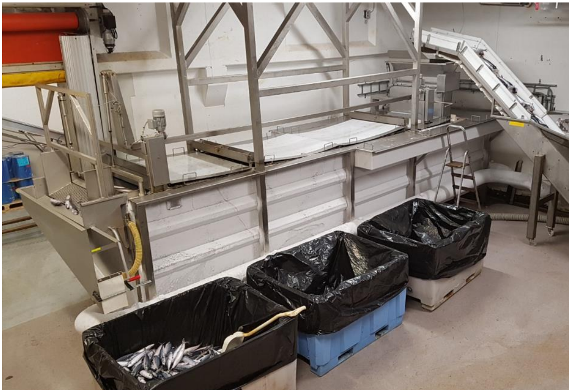
Bilde: Kontinuerlig fryser installert på Selje.
