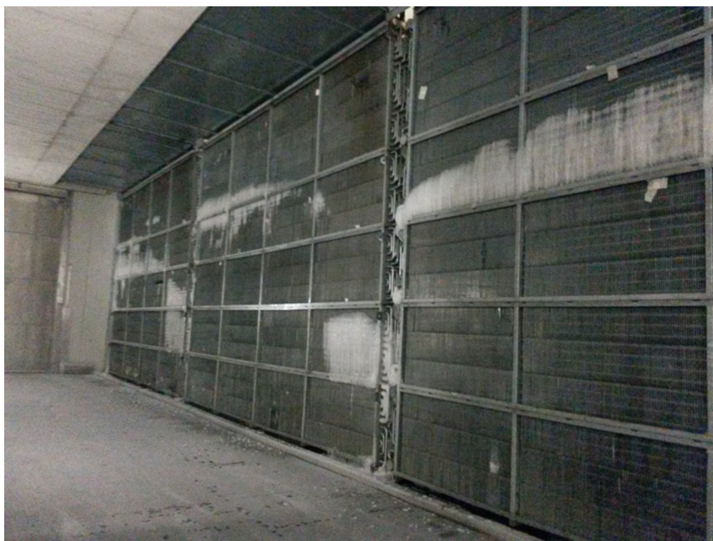
Figur 7.10 Is på fordampere i tunnel 3 før avriming.
