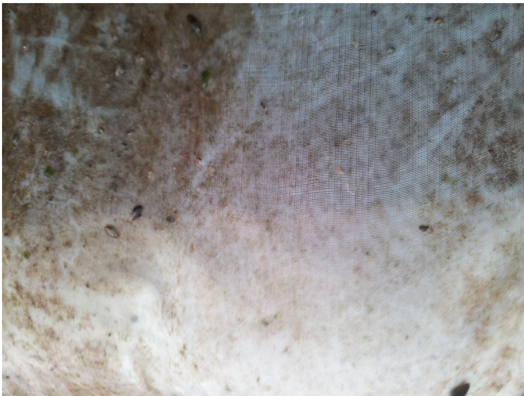
Figur 3: 10-metring vasket ved 100 bar med antydning til skade og ikke tilfredsstillende rengjøring.
