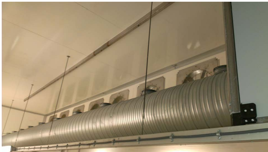
Figur 6: Sirkulasjonsvifter i kammertørken, samt kanal fra kjøleaggregat.
