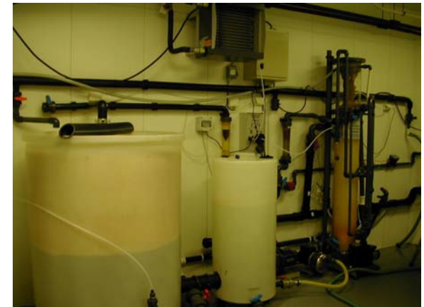
Biofilter, pumpeump og proteinskimmer
