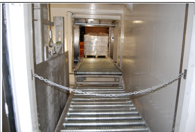
Bilde 31 Paller fra heis til skipsside
