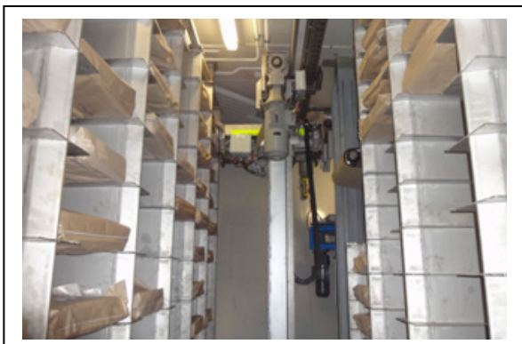
Bilde 9 Mellomlager med reolrobot i midten
