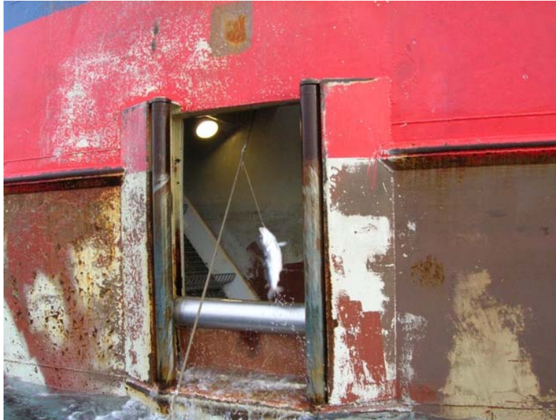
Foto 3 Inngangsluke, ALH. Vi ser fisk på tur inn og deler av transportbåndet. Foto: I. Tatone
