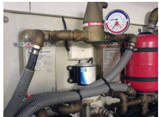
Bilde 5: Varmegjenvinningsanlegg i deltakerfartøy
