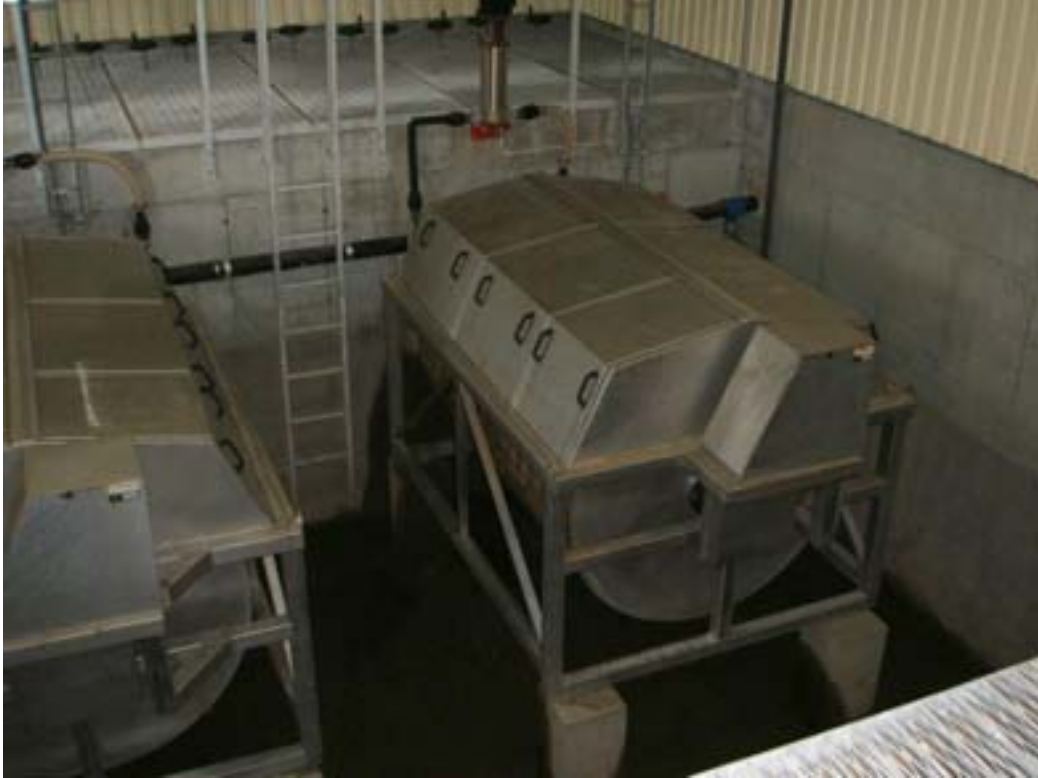
Figur 3. Avløpsfilter som sekundærsikring
