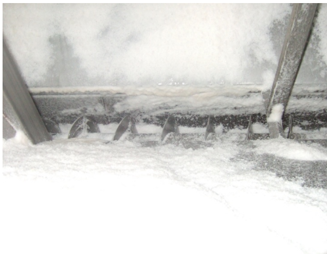
Bilde 7: Skrue som overfører salt til kar
