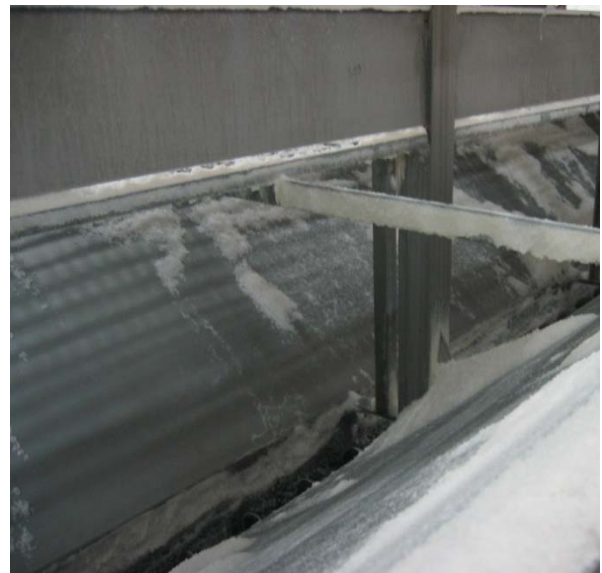
Bilde 6: Oppsamler under ristene
