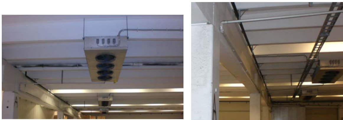
Figur 2 Fordamper-rekker i kjølelager
