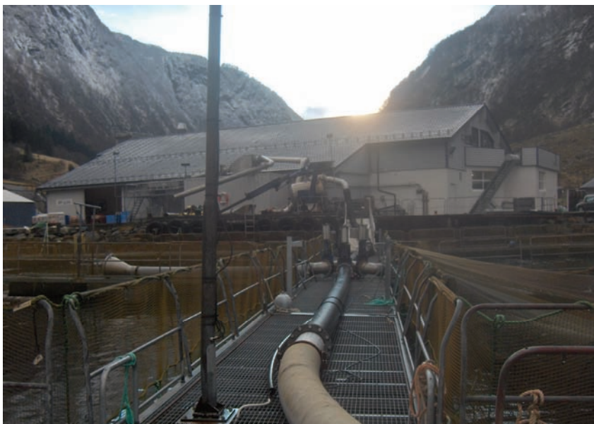
Figur 36. Slakteri D. Bildet viser ventemerder på begge sider av flytebygga med rør til vakuumpumpen som er plassert på kaia. Avsilingskassen er synlig over og til venstre for pumpa, og elektrobedøveren ses på utsiden av veggen til høyre for skyvedørsporten. Legg merke til flere krappe bend som fisken må passere.
