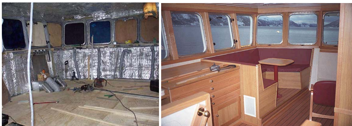
Figur 8: Bildet til venstre viser et isolert styrhus, mens bildet til høyre viser et ferdig innredet styrhus i aluminium. Bildet er hentet fra Naval-Consult sine hjemmesider.
