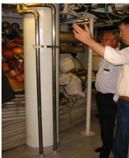
Figur 20: Kranen vist i figur 19 er festet til et gjennomgående stålrør. Hensikten er å fordele kreftene og momentene over et større areal, slik at sandwichdekket ikke skades.
