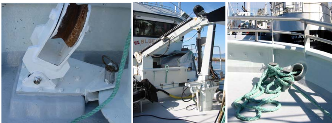
Figur 19: Typiske eksempler på innfesting av sjakler, kraner og trossefeste til et sandwichskrog. Eksemplene er hentet fra båten "Bluefin", levert av Mundal Båt AS.
