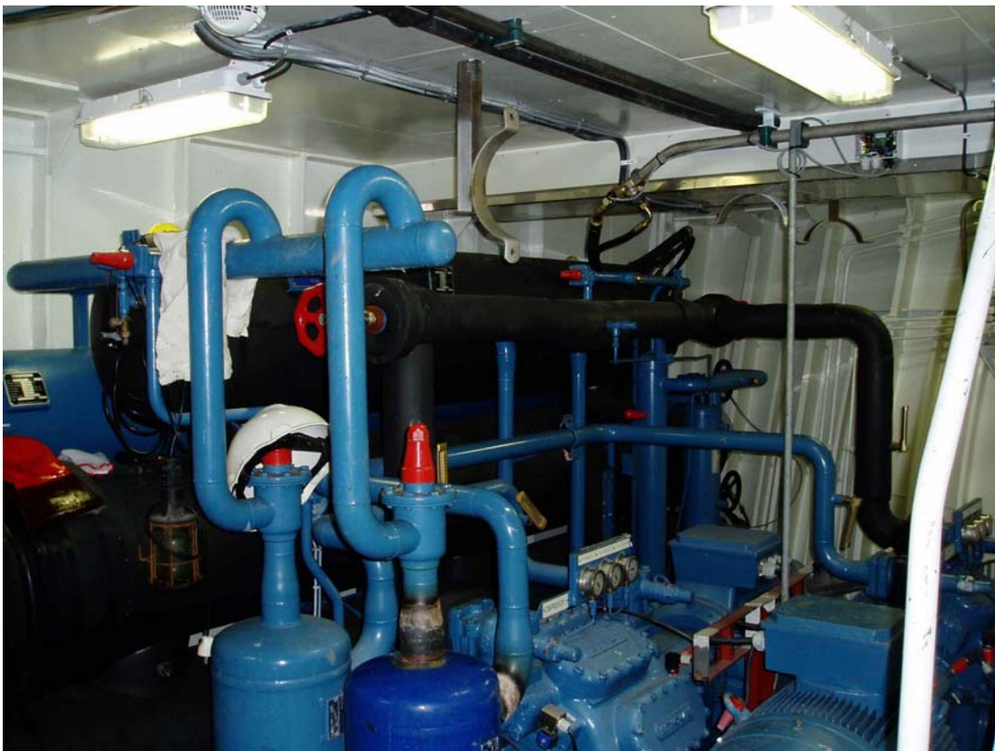
Bilde 24 Maskinrom forut for kjøleanlegg med kompressorer, kondensatorer m.m.
