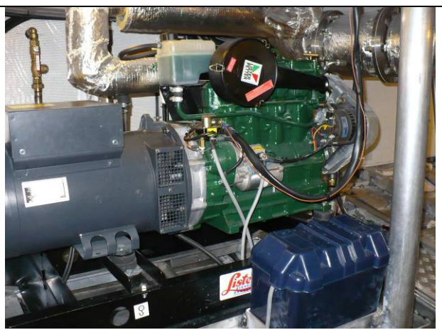
Dieselaggregat - Sabb / Lister 12 kVA
