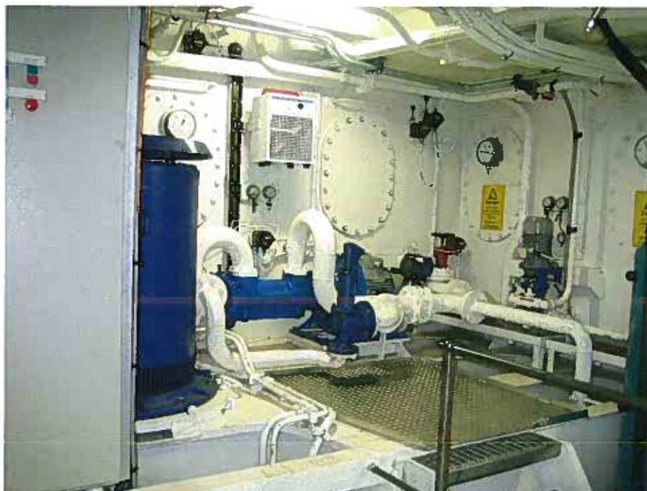
Figur 7 I dette området av maskinrommet kan kondensatpumpene plasseres
