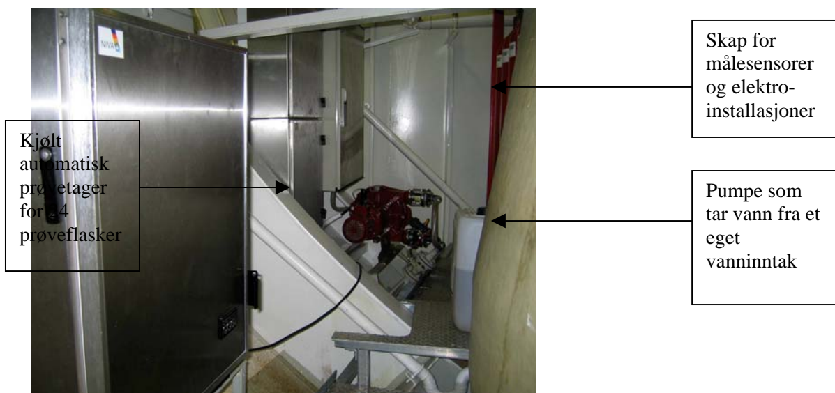
Figur 2. Oversikt over installasjonen om bord i MS Trollfjord i fremre pumperom.
